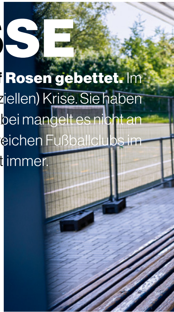
Die Tribüne des Sportplatzes Kaiserberg hat schon bessere Zeiten gesehen und soll abgerissen werden.
